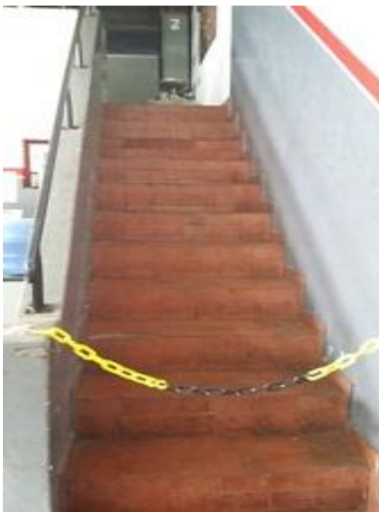
FIGURA 26 - ILUSTRA O ACESSO AO ALMOXARIFADO APÓS A RESTRIÇÃO.
